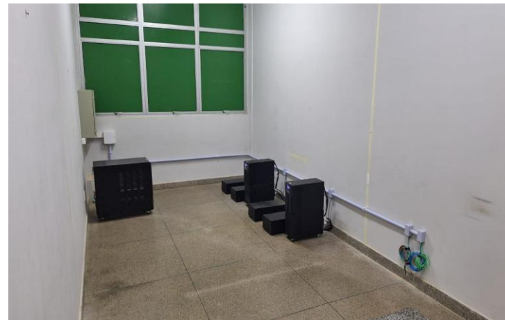
Figura 10: Sala de nobreak e de energia do Data Center
