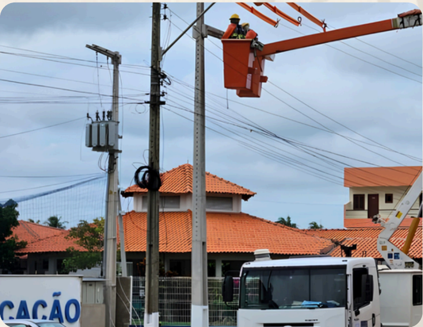
Figura 5 - Implantação de subestação e projeto de eficiência energética na Escola de Aplicação
